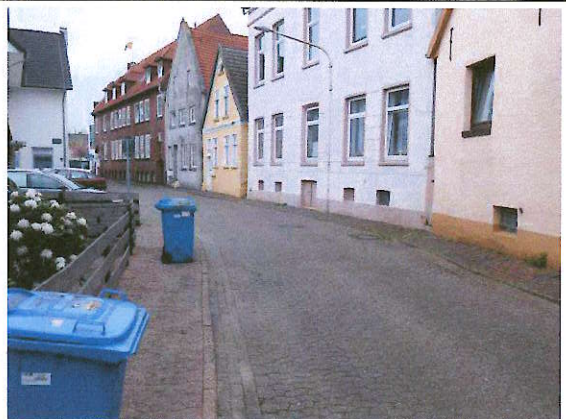
Deichstraße - technische und gestalterische Mängel
