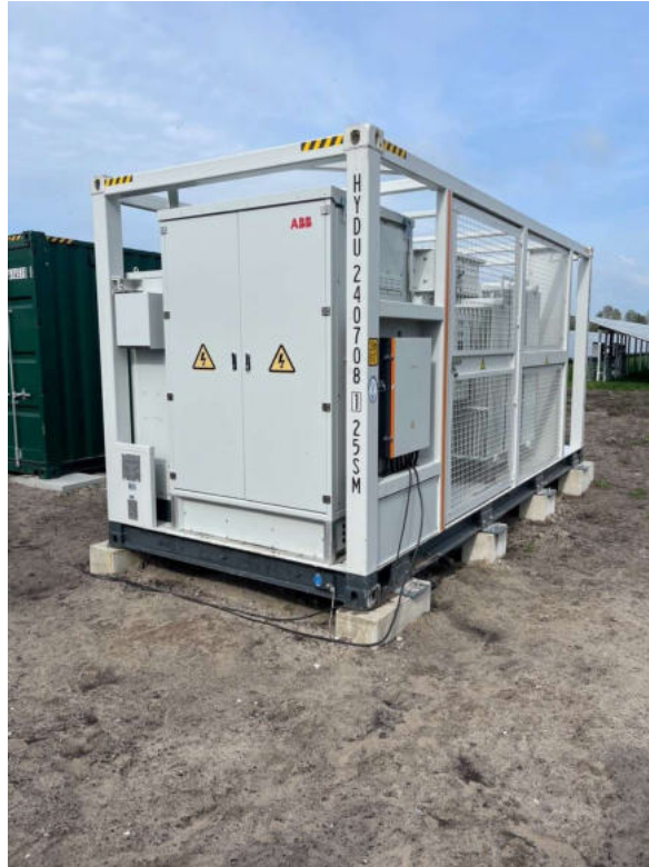
Abbildung 5: Skid-Bauweise einer Transformatorenstation auf Betonpfählen
